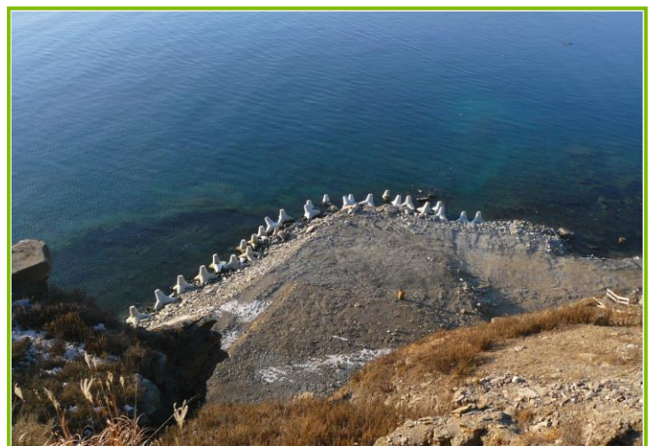
从陆地到海底的 220 kV 电缆过渡点。
